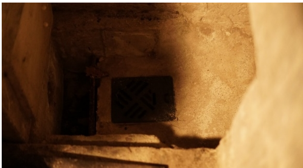
Figur 11 Sump og gulvafløb
