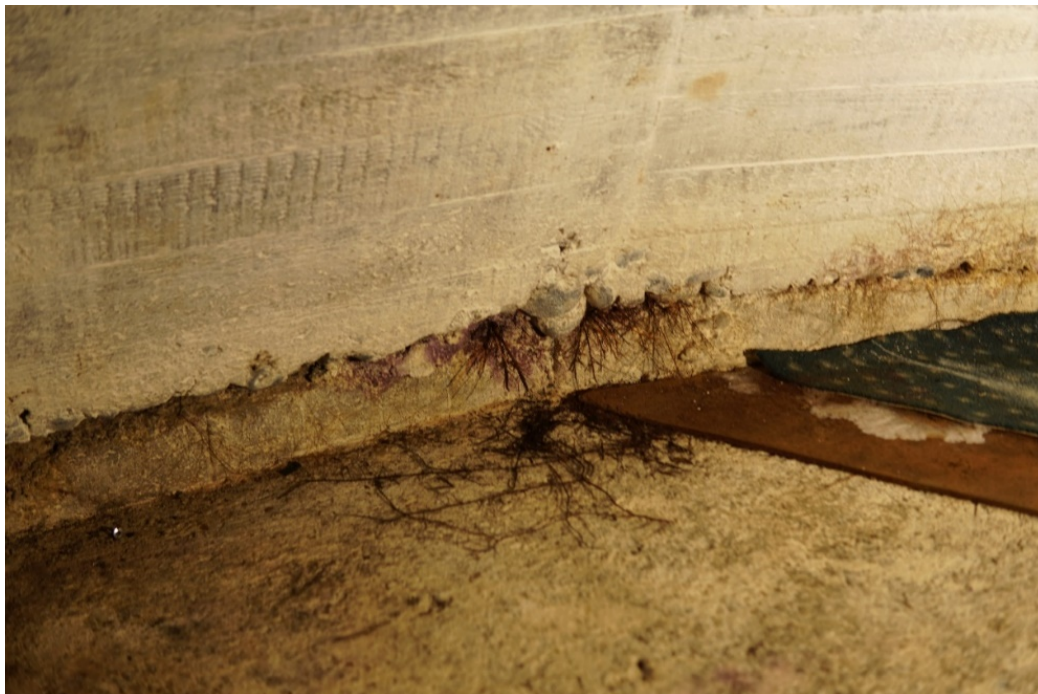
Figur 6 Eksempel på revne i samling mellem gulv og væg. Billedet viser også et eksempel på en betondækningsgrav, hvor gulvet er sunket. Bemærk farveforskellen mellem gulv og væg.
